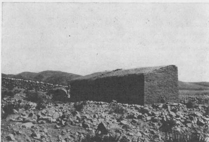
Fig. 45. — Casa en construcción en la que puede advertirse la forma de techar, poniendo sobre el envarillado una primera capa de paja y recubriéndola luego con barro amasado con pequeños guijarros
